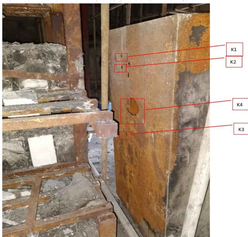
图 1 开关柜背部孔洞
