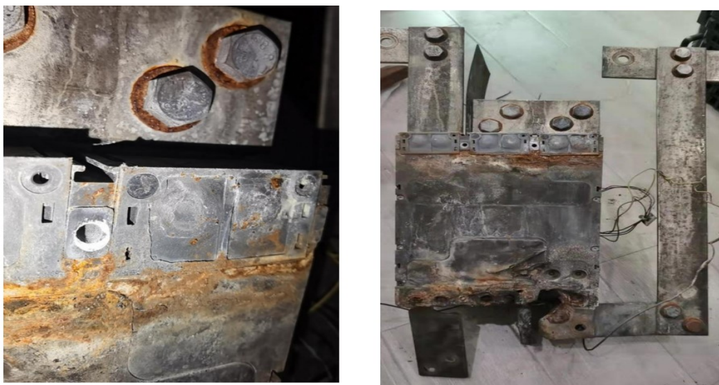
图 7 KGX-1#开关柜断路器底壳被顶裂
